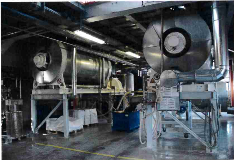
Bereich Trocknungsservice: Produktionshalle mit Schaufeltrockner
