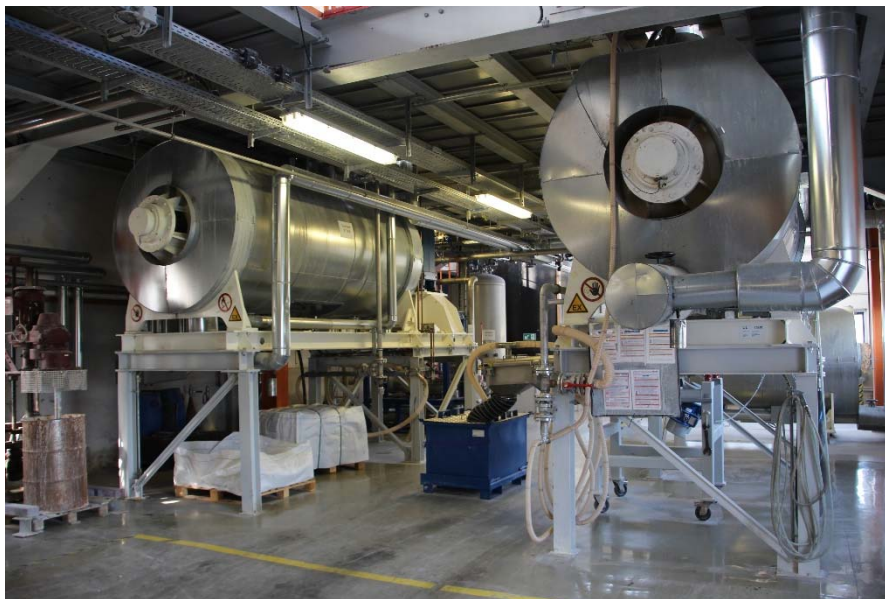
Bereich Trocknungsservice: Produktionshalle mit Schaufeltrockner
